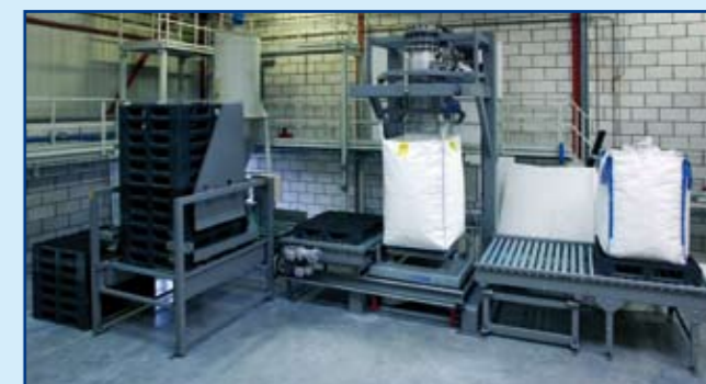
Voorbeeld van een componentenplus installatie.
